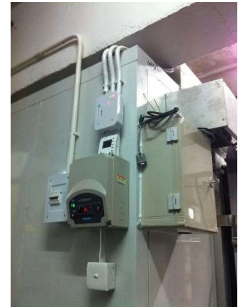
業務用冷蔵庫設置例
